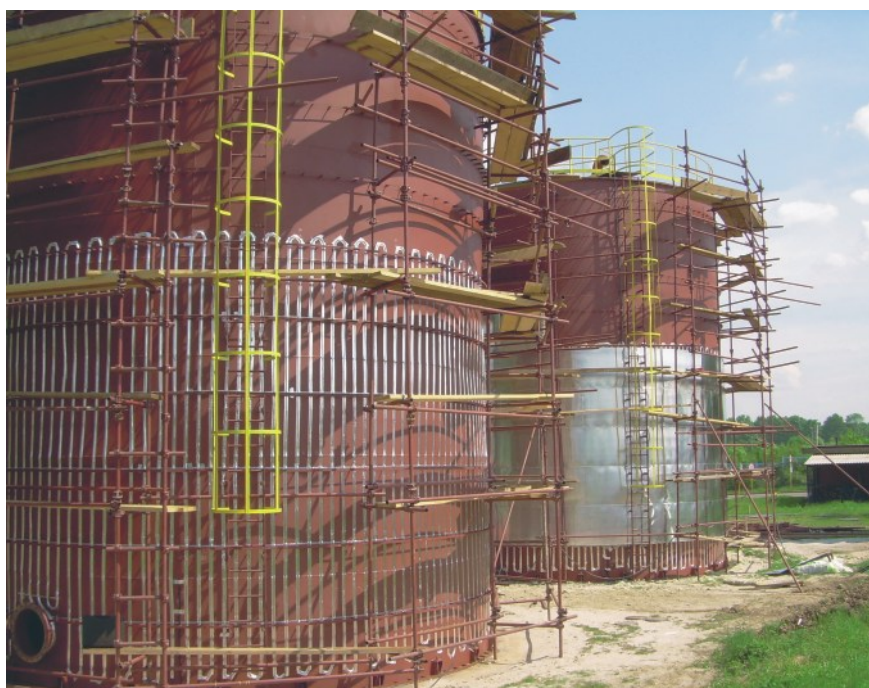
Нагревательные кабели, расположенные на резервуаре
